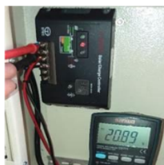
Gambar 16. pengecekan tegangan pada SCC dari solar cell
