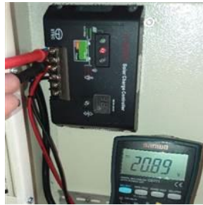
Gambar 16. pengecekan tegangan pada SCC dari solar cell
