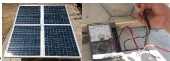
Gambar 17. Pengujian tegangan pada panel surya cell
