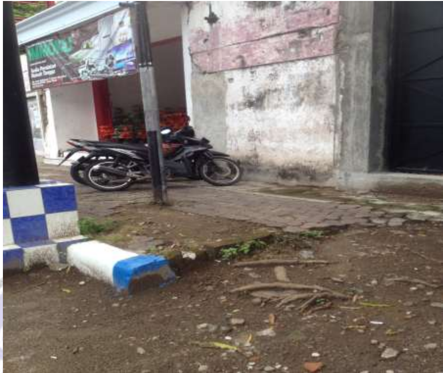
Kondisi Trotoar yang rusak dan tidak layak
