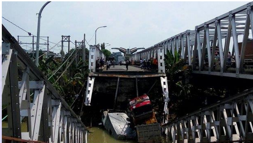
Gambar :1.1 Jembatan runtuh. Sumber : Liputan 6.com
